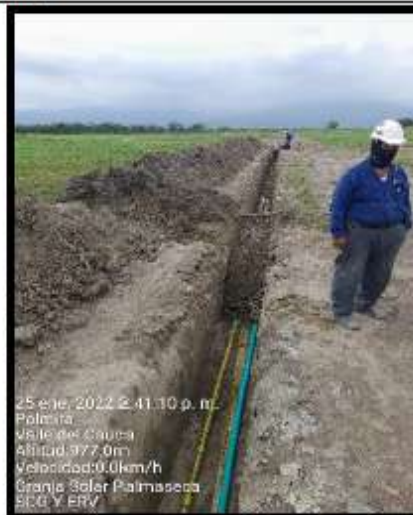
Fotografía 16. Canalizaciones eléctricas AC
